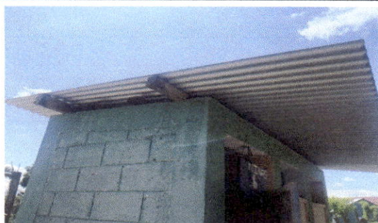
Foto 5: Estructura de madera en malas condiciones.
