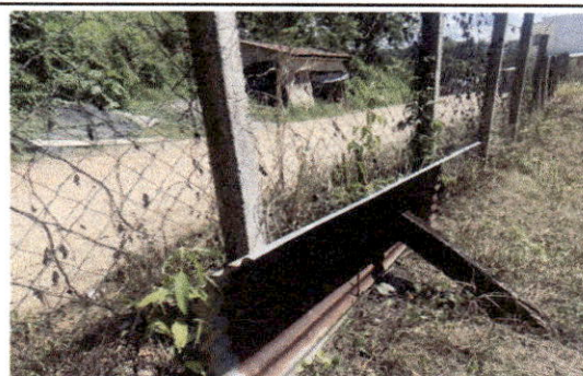
Foto 4: Cercado de malla lado posterior en muy mal estado.
