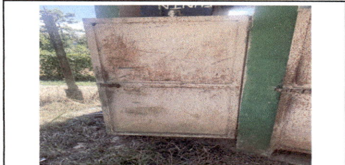
Foto 11: Puertas de sanitarios oxidadas.
