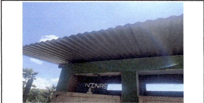
Foto 7: Láminas onduladas desgastadas.
