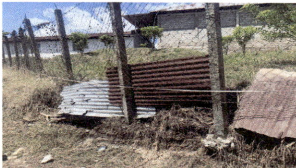
Foto 6: malla perimetral en mal estado y con postes de madera.
