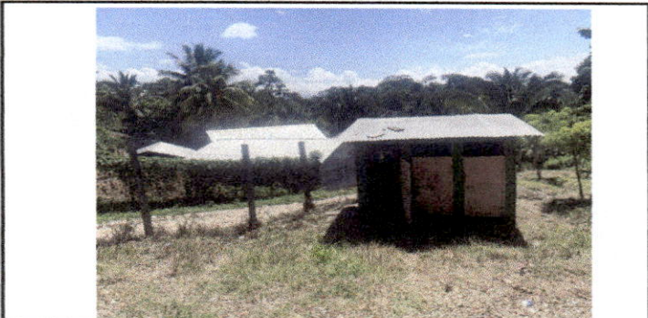
Foto 8: Servicios sanitarios en malas condiciones.
